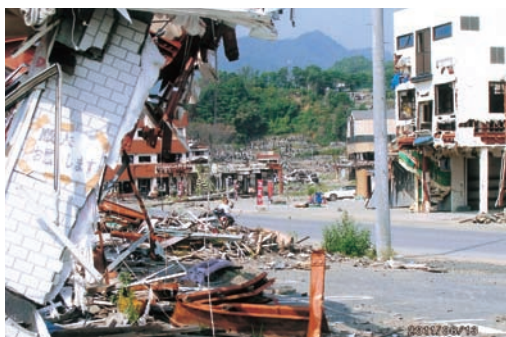
大槌町の市内にはまだこの様な建物が残されており、全ての解体が終了するのはいつのことか
